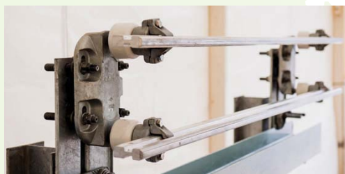
● 澳門輕軌以電力推動，供電軌道為輕軌列車提供穩定的電源
