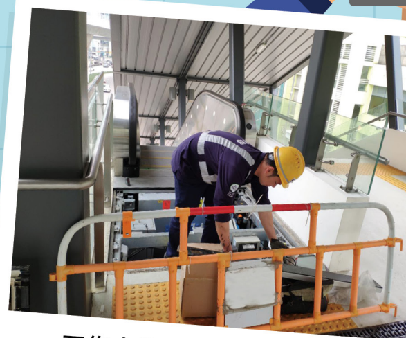
工作人員於運動場站內檢查 扶手電梯裝置
