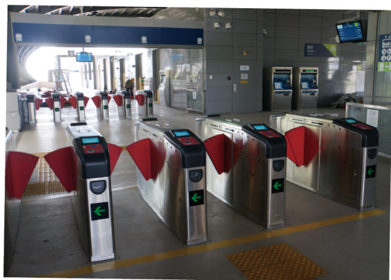
設於車站大堂的入閘機
