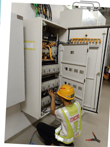
工作人員於氹仔碼頭站 機房內調整系統設備
